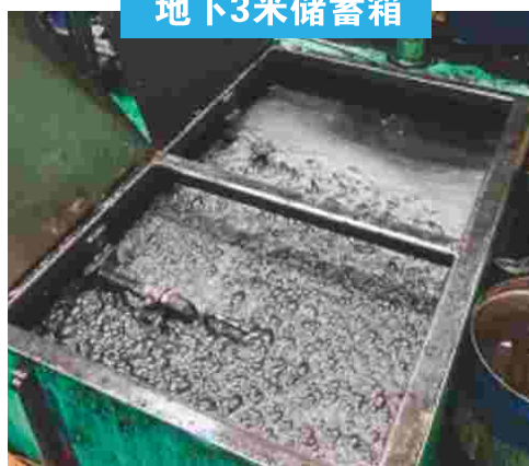
地下3米储蓄箱
